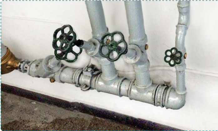
Entleerungsventile durch Messing-Stopfen verschlossen.
