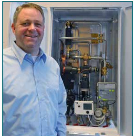
Ihr SWN-Experte Jörn Heitmann vor einer modernen, heizwasserversorgten Fernwärmeübergabestation.
